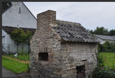
Ancien fournil du 19 ème siècle, en calcaire, près et brique sous bâtière de tuiles, largement remanié, partiellement détruit accidentellement en 2009, et restauré en 2010.
